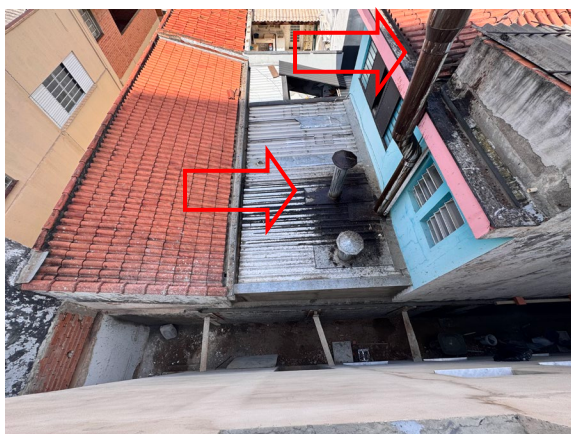
Vista geral da parte posterior da hamburgueria, onde se localiza a chaminé próxima à fachada lateral do imóvel pertencente ao CRECISP. Com o passar do tempo, a fuligem e gordura proveniente da chaminé comprometeu a pintura da alvenaria externa, além de provocar acúmulo de sujeira nas caixilharias do auditório e da área dos fundos.
