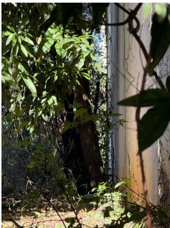
Vista sob o ponto de vista do lado externo da mesma região onde foi fotografada as fissuras na alvenaria de blocos de concreto do interior do galpão comercial. Observa-se um tronco de árvore até com certa inclinação bem na região que faz divisa com galpão comercial podendo levantar suspeita sob a sobrecarga que as raízes deste tronco pode estar causando na alvenaria de vedação do galpão comercial.
