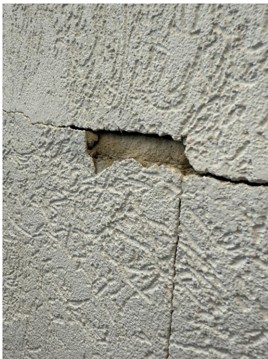
Foto da espessura da camada de revestimento da alvenaria que em algumas regiões apresentava som "cavo", indicativo de perda de aderência ao bloco de concreto.
