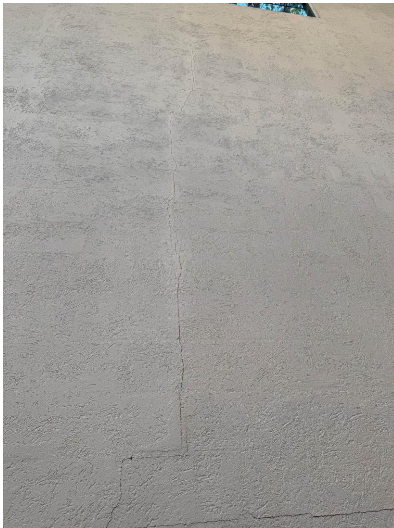
Vista das trincas na alvenaria de vedação em blocos de concreto sob a vista de dentro do galpão comercial da loja de carros.
