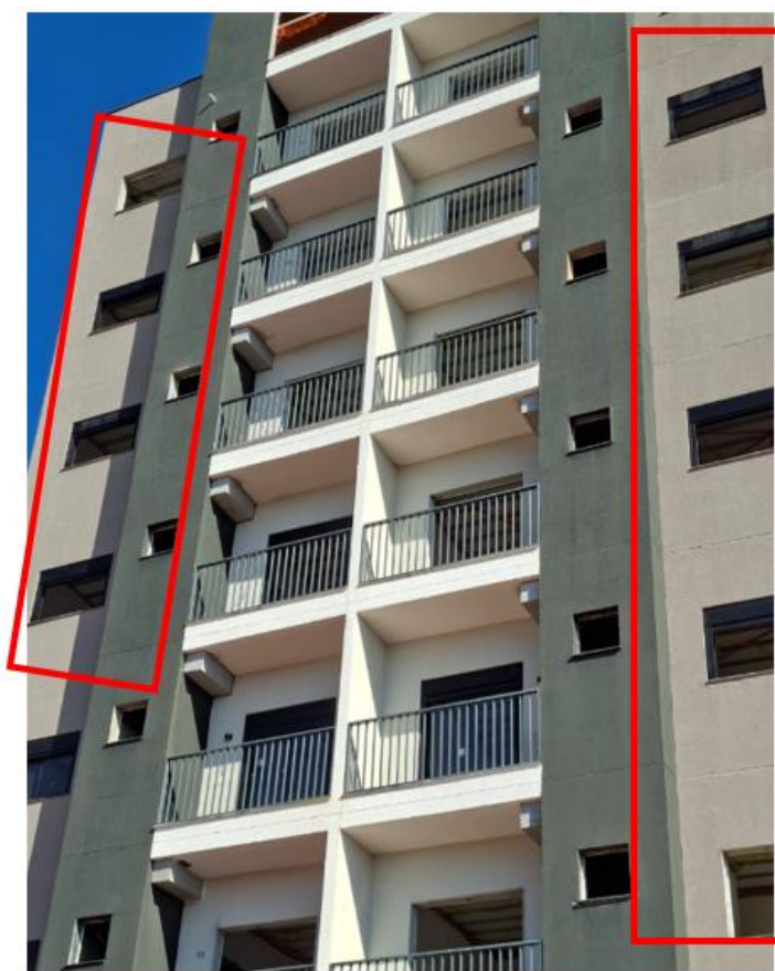
10/06/2026 - Janelas Sem vidros instalados
